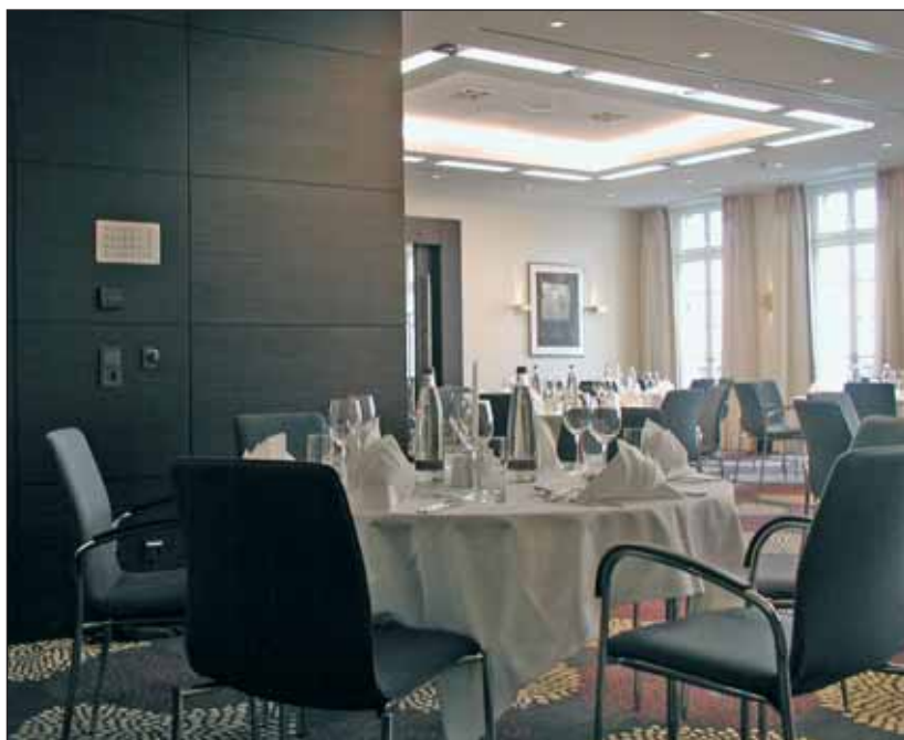
Blick ins Restaurant. Die Bedienung der Beleuchtung erfolgt hier über beschriftete Tableaus mit Tastern und LED-Anzeige.
